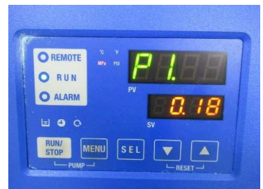
循環液吐出口圧力
